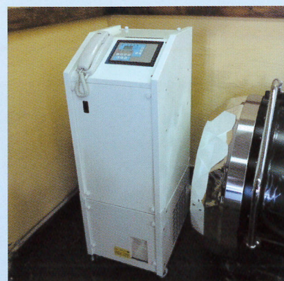
コントロールボックス
